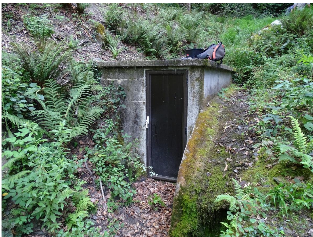
Illustration 12 : Clichés de l'ouvrage de captage de « Source de l'Argen »
